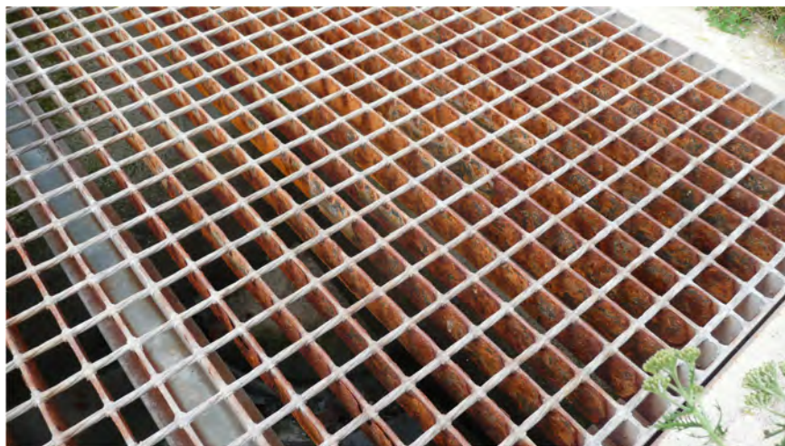
Abbildung 28: Korrosion am Trübwasserschacht des geschlossenen Schlammstapelbehälters der Anlage SG, am 28.09.2015
