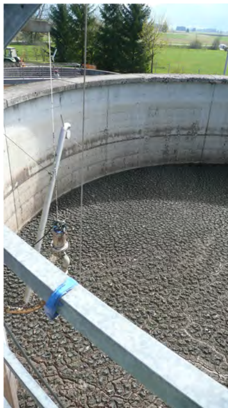
Abbildung 55: Schlammstapelbehälter der Kläranlage WG mit dichter Schwimmdecke, am 10.07.2015
