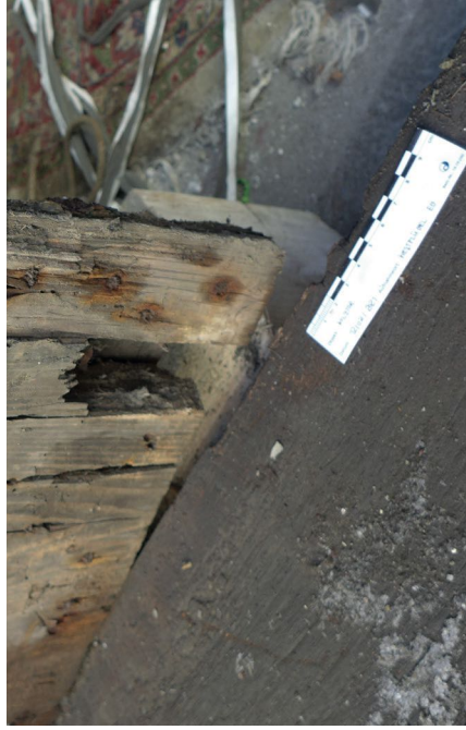
Abb.: 9 Spalt zwischen Tor und Holzbohle außen
