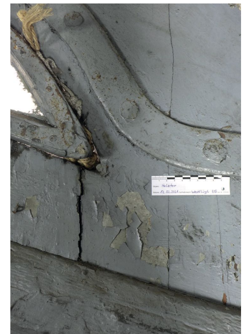
Siehe Tabelle Mangelnder Übergang 3 Risse 3
