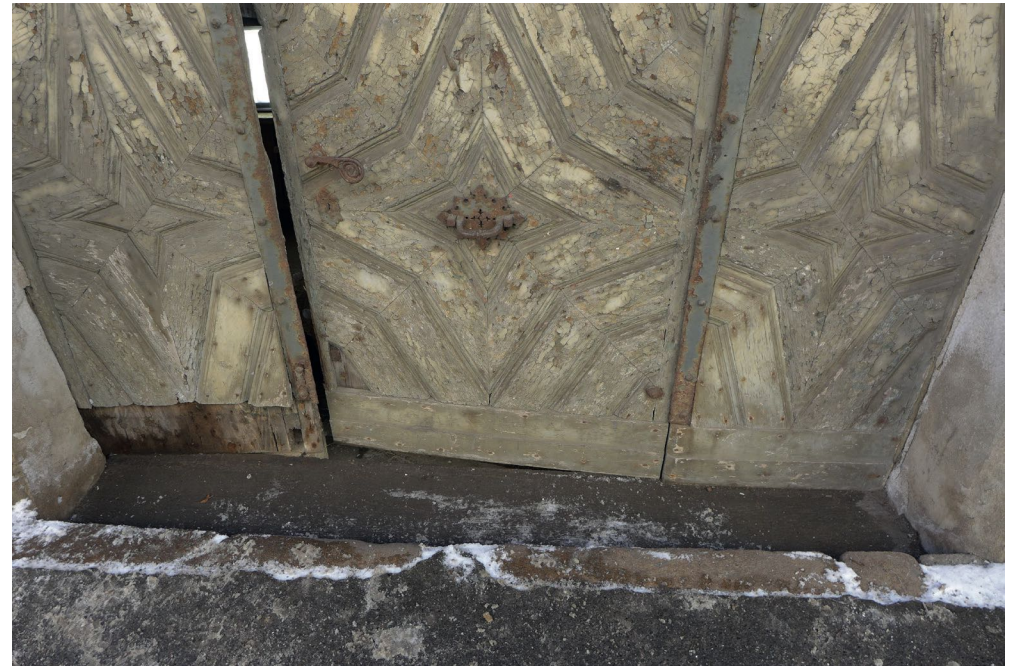
Siehe Tabelle Feuchteschäden 1; Zutat 3; Aufblättern/ Korrosion 1-2
