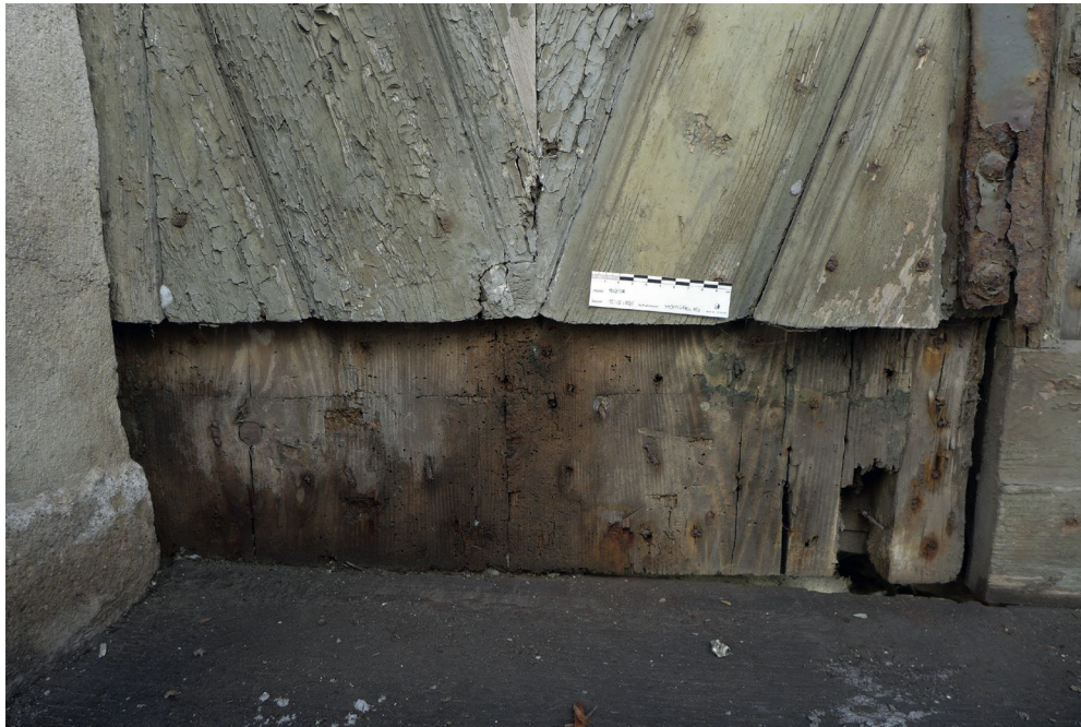
Siehe Tabelle Feuchteschäden 1
