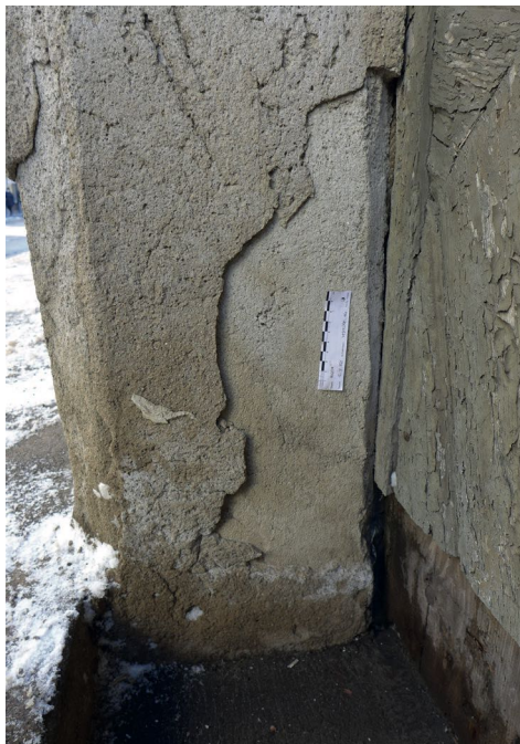
Siehe Tabelle Feuchteschäden 1
