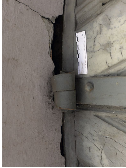
Abb.: 6 Loch im Sturzbereich
