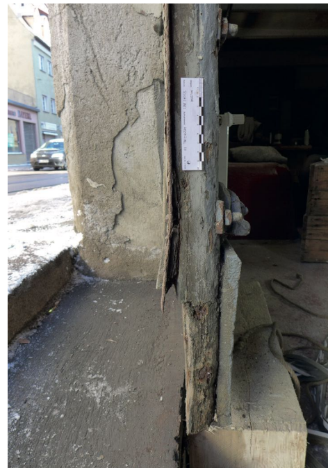
Siehe Tabelle Feuchteschäden 1; Mangelnder Abschluss 1; Zutat 1/2/3
