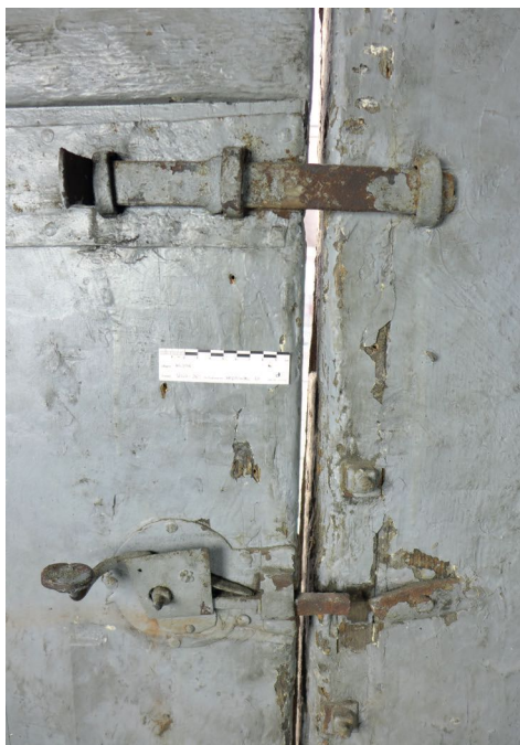
Siehe Tabelle Mangelnder Übergang 2 Abbruch/ Fehlstellen 2
