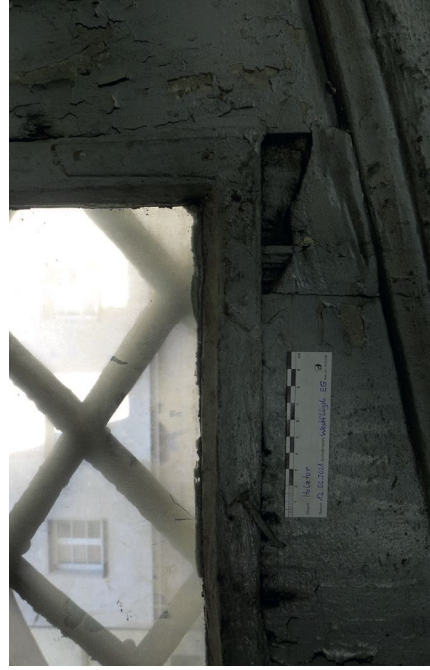
Abb.: 15 Loch unterhalb des linken Fensters
