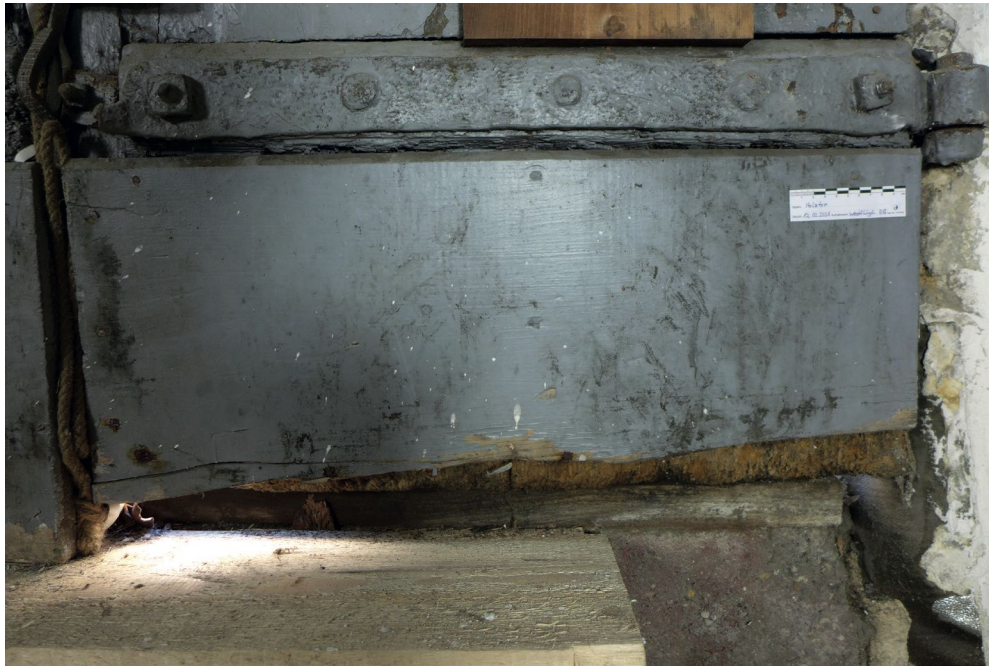
Siehe Tabelle Feuchteschäden 1; Zutat 3
