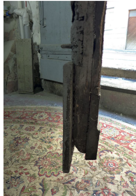
Siehe Tabelle Feuchteschäden 1; Zutat3
