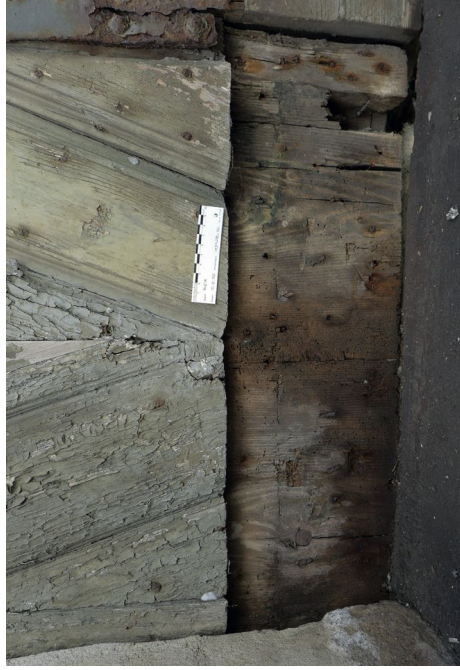
Abb.: 2 Morsche Konstruktion
