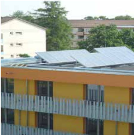
Abb. 159: Solarthermische Anlage in München
