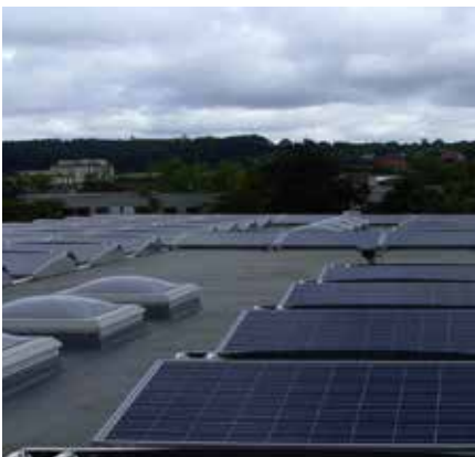
Abb. 161: Photovoltaikanlage in Ansbach
