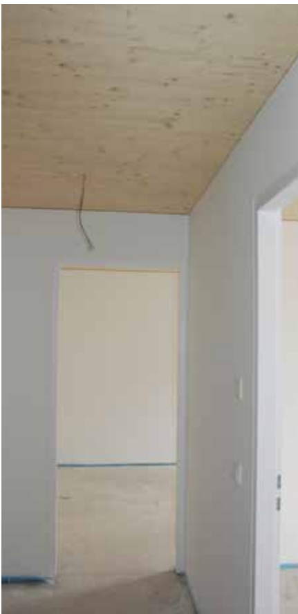
Abb. 56: Lampenanschlussmöglichkeit in der Decke
