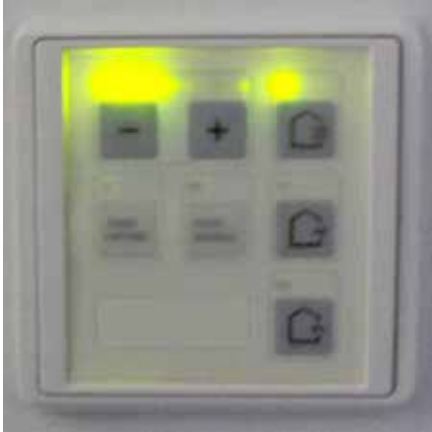
Abb. 108: Bedienelement der Lüftungsanlage im Flur
