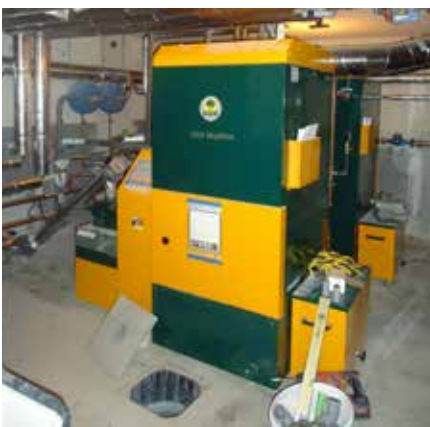
Abb. 40: Pelletkessel im Kellergeschoß
