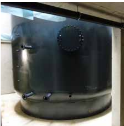
Abb. 160: Warmwasserspeicher in Ingolstadt Bauteil 1
