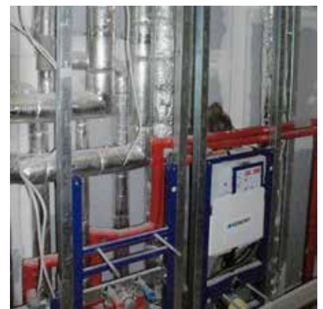
Abb. 59: Installationswand im Bad
