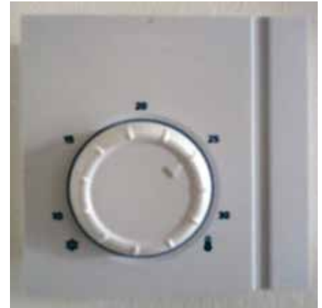
Abb. 123: Thermostatregler für die Fußbodenheizung
