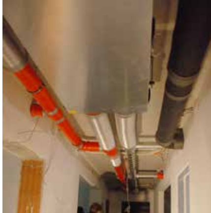
Abb. 109: Vertikale Leitungsverteilung im Flur vor dem Einbau der abgehängten Decke
