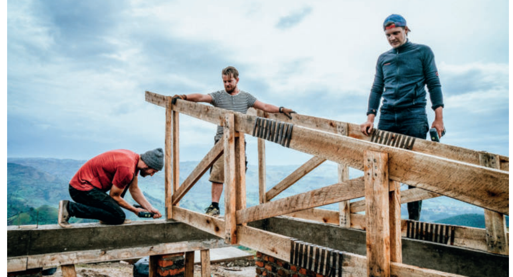
Befestigen der Dachbinder auf dem Ringanker Fixing the roof trusses to the ring beam
