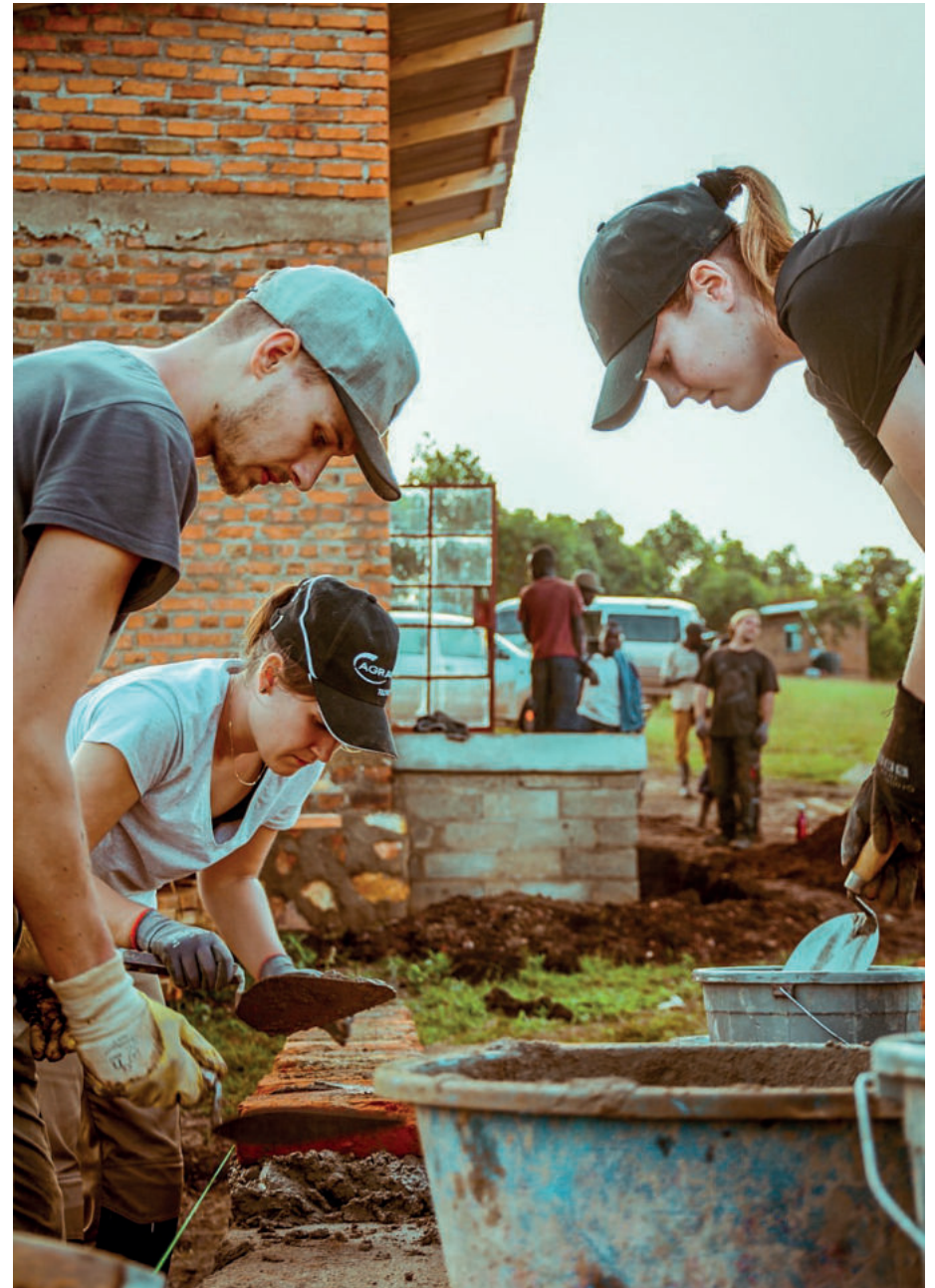
Mauerarbeiten für den Innenhof des Lern- und Wohnclusters Masonry work for the courtyard of the learning and living cluster
