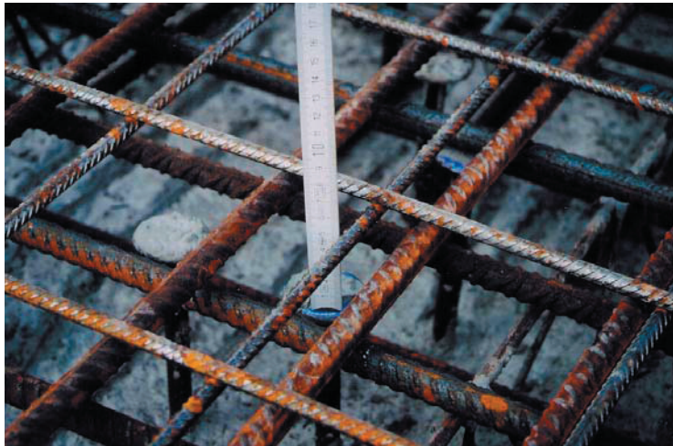
Bild 1: Erheblich zu kurz eingebaute Doppelkopfanker
