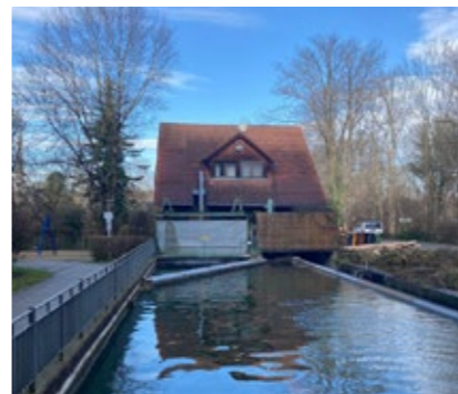
Das Wasserkraftwerk am Hanreibach, einem Augsburger Stadtkanal. Foto: Tobias Dempfle
